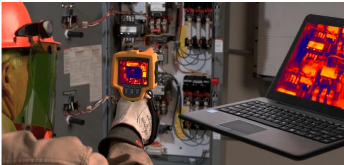
Рисунок 20. Пример проведения тепловизионного контроля электрошкафа
