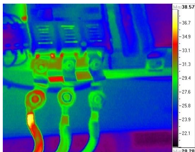
Рисунок 21. Пример термограммы контактных соединений с температурной шкалой
